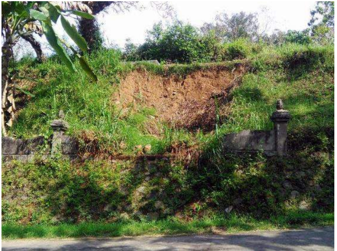
Pinggiran makam yang longsor, foto diambil setelah jalan desa dibersihkan
